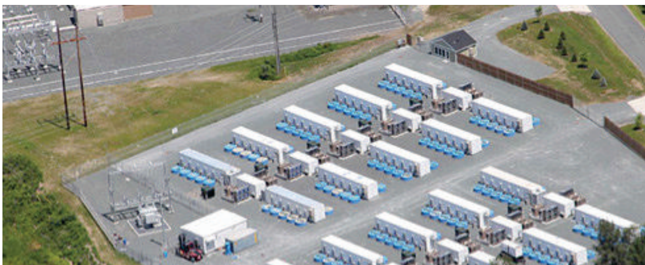
Impianto di volani (20 MW – 5 MWh) entrato in funzione nel 2011, Stephentown (New York)
