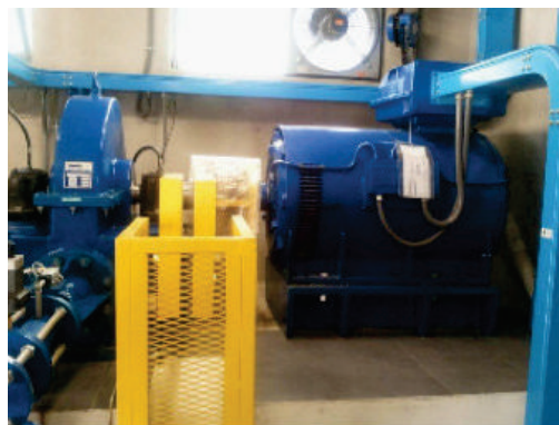
Centralina idroelettrica nell'acquedotto di Roncobello (BG) [18]
