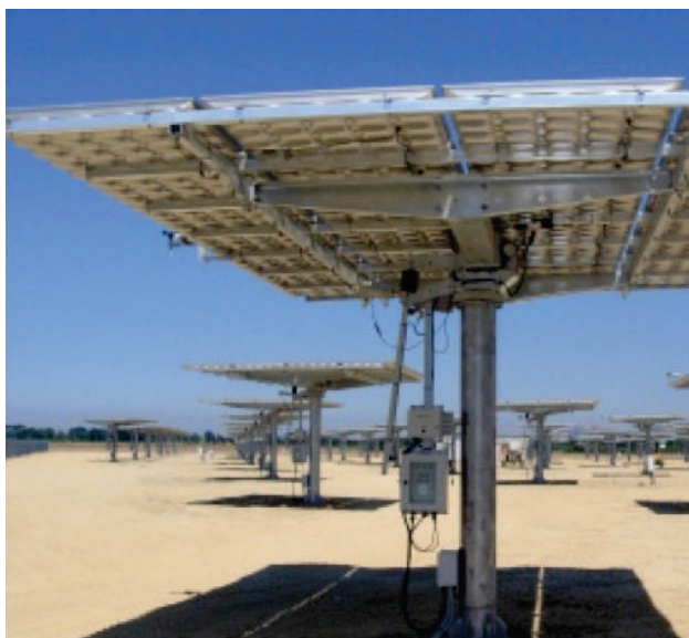
Parco solare in Abruzzo, installato da SolFocus (USA) e dalle aziende Sistema Solare e Delta Group (IT)
