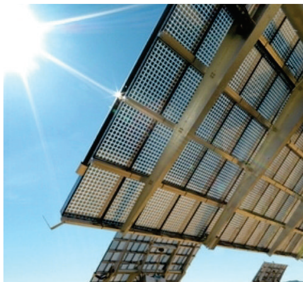
Impianto fotovoltaico di Belpasso (Catania) realizzato da Soitec
